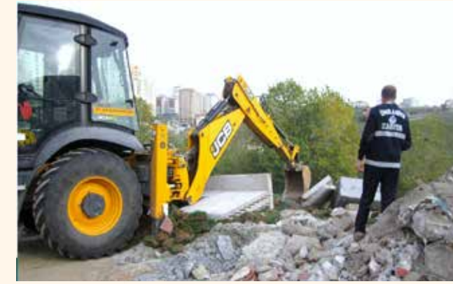
» Kaçak kazı ve hafriyat tespiti
